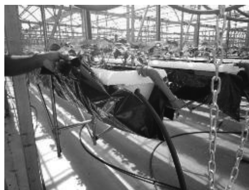
図 2 黒色フィルムを利用した排水設備
