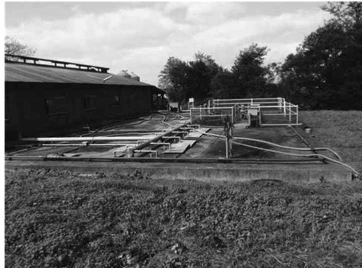
安中牧場浄化槽設備
