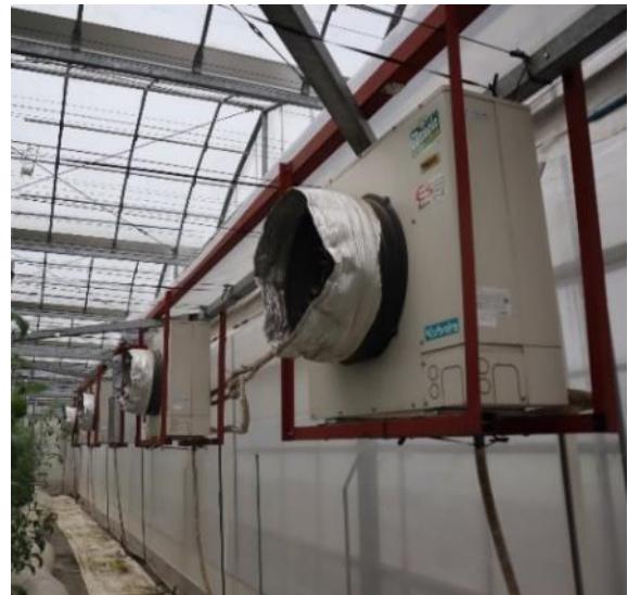
写真7 ヒートポンプ
