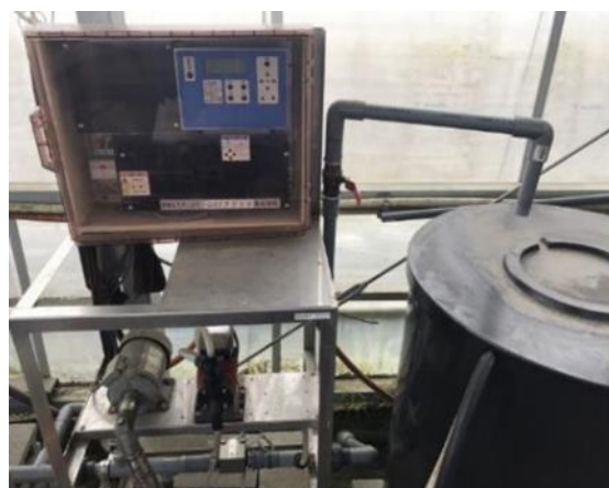
写真9 養液土耕システム
