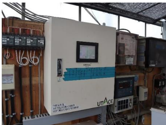
写真8 統合環境制御装置
