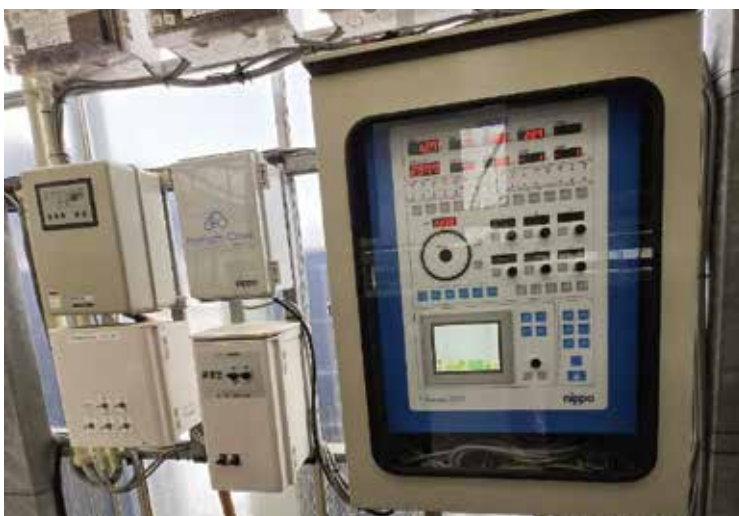
写真9 統合環境制御装置
