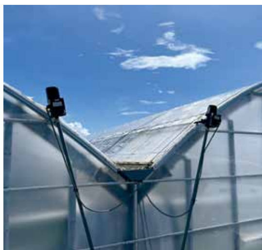
写真12 自動開閉装置
